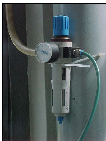
Figura 17 – Unidade de controle de pressão e filtragem do ar.
